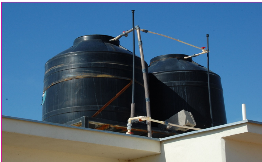
Ilustración 9. No se utilizan materiales de alta calidad en las instalaciones.
