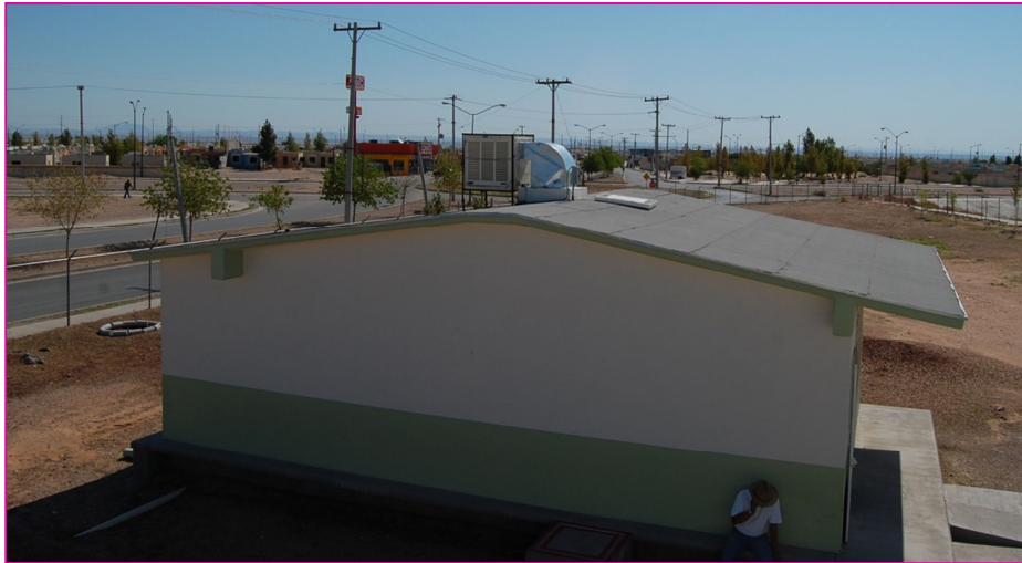
Ilustración 8. Los muros y techos no cuentan con aislamiento térmico.
